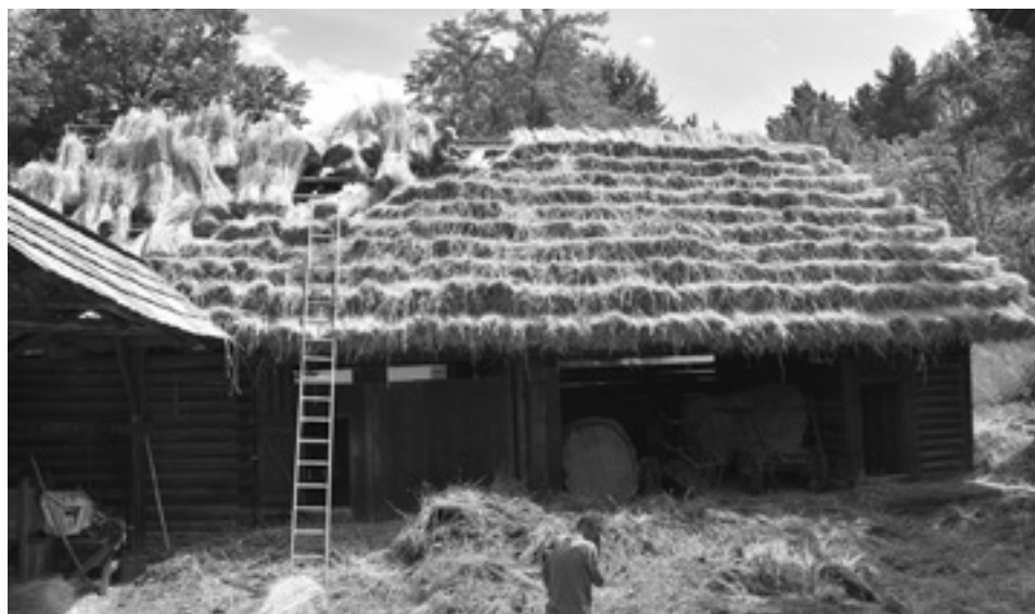
Obr. 2. Kladenie slamenej strešnej krytiny na hospodárskej stavbe usadlosti z Jasenovej. Foto T. Kadlecová, 2019 Fig. 2. Placing straw roofing on the farm building of the homestead from Jasenová. Photograph by T. Kadlecová, 2019
